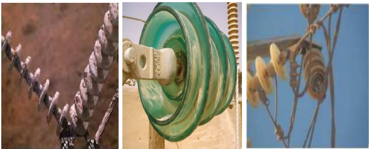
a- Pollution marine b- Pylône implante près du sol en l'argile (usine de briqueterie, Pollution désertique)
