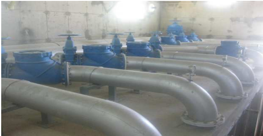
Figure №04 : puits de pompages( originale ).
