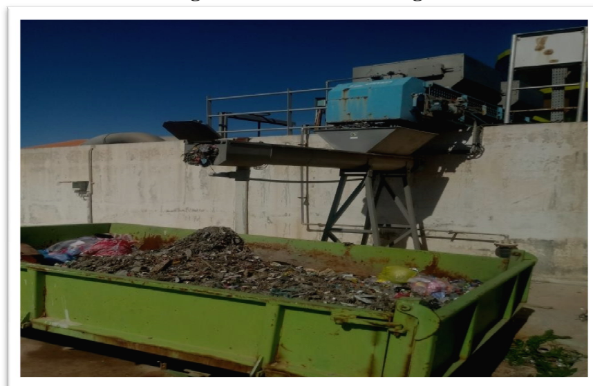
Figure « 15 » : Bassin de récupération
