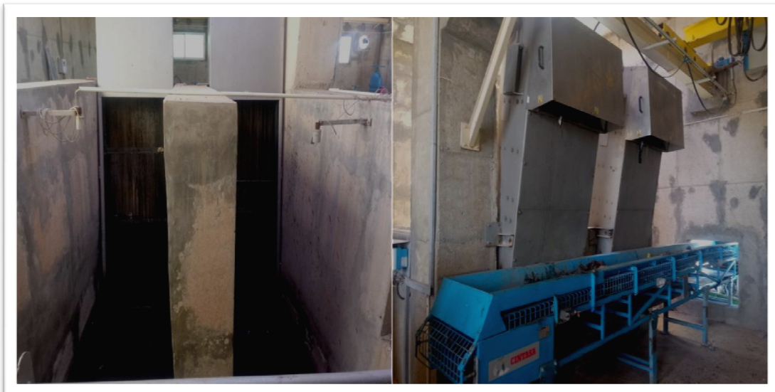
Figure « 12 » : les grilles grossières.
