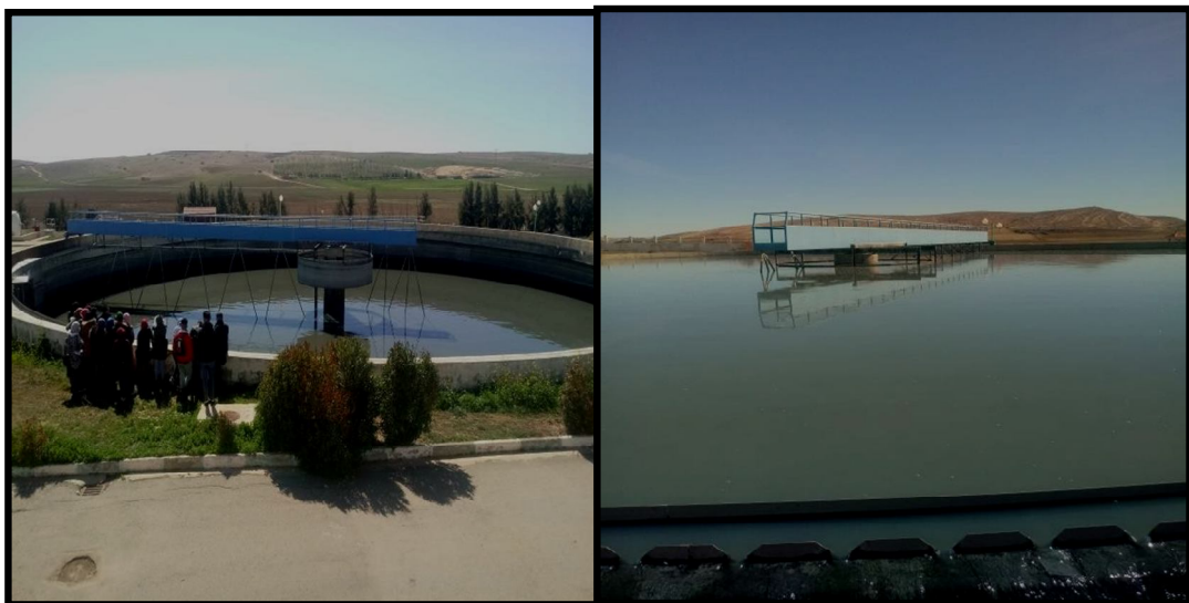
Figure « 17 » : le décanteur.
