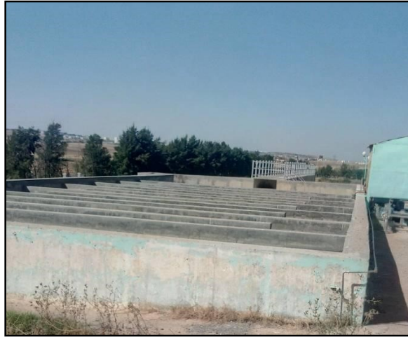
Figure 27 : Bassin de désinfection
