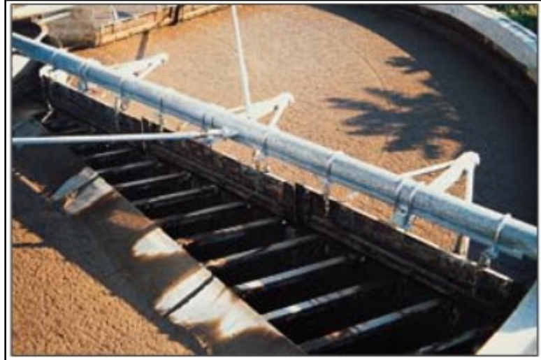
Figure 14 : Etape d'épaississement des boues par flottation.(Quénéa et Belhadj-Kaabi, 2009).
