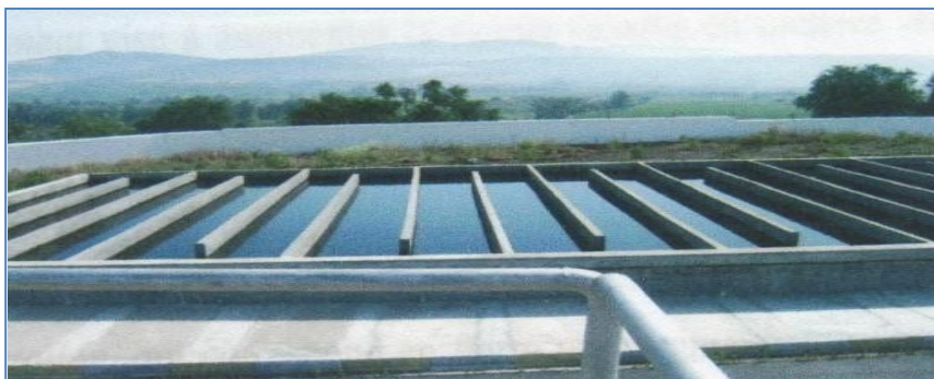
Figure 8 : Bassin de la désinfection par le chlore (Moumene et Djemame, 2011).
