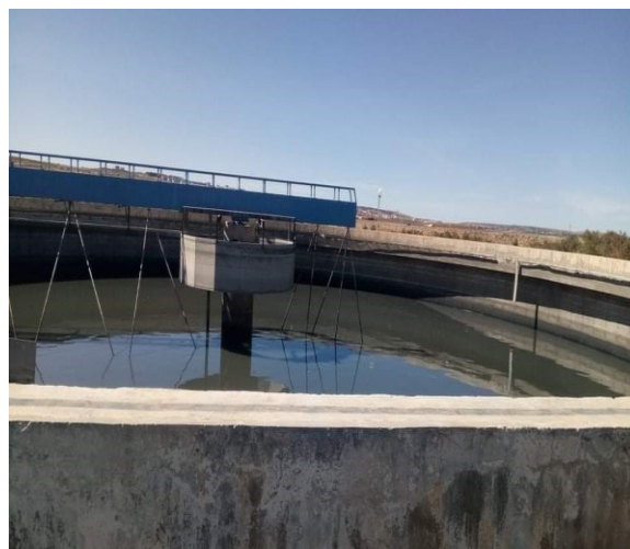
Figure 26 : Bassin de décantation secondaire
