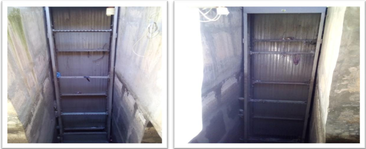
Figure N° 9: les grilles grossières.
