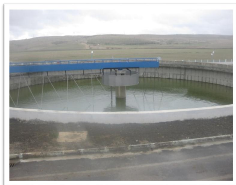
Figure№ 15: le décanteur.
