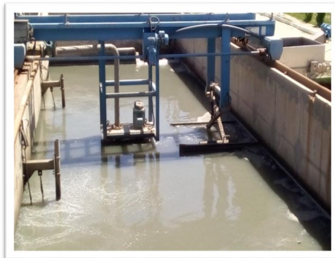
Figure N° 12: pompe à sable et racleur
