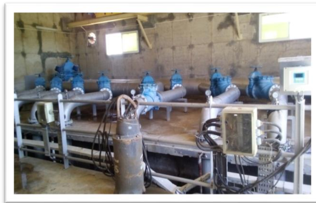
Figure N° 10: puits de pompages.
