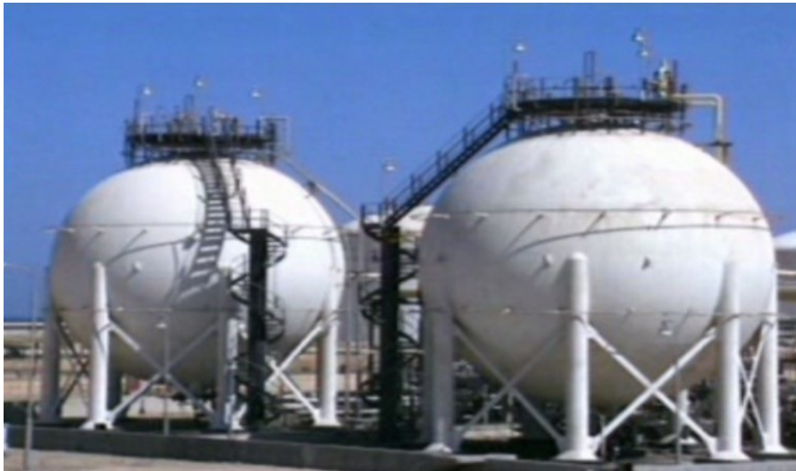
Figure I.7 : Sphère de stockage butane ambiant.
