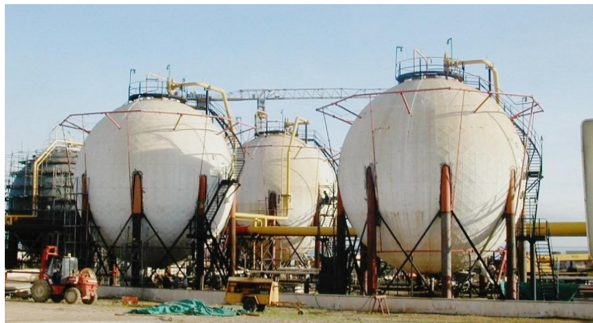
Figure II.1 : sphères de stockage tampon de GPL.
