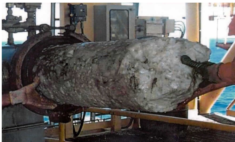
Figure III.3 : Hydrate sortie d'une gare racleur.
