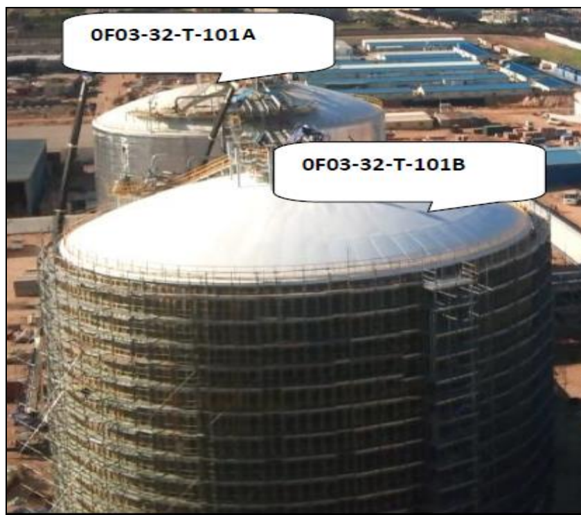
Fig.3.8 - Bac de stockage de l'ammoniac
