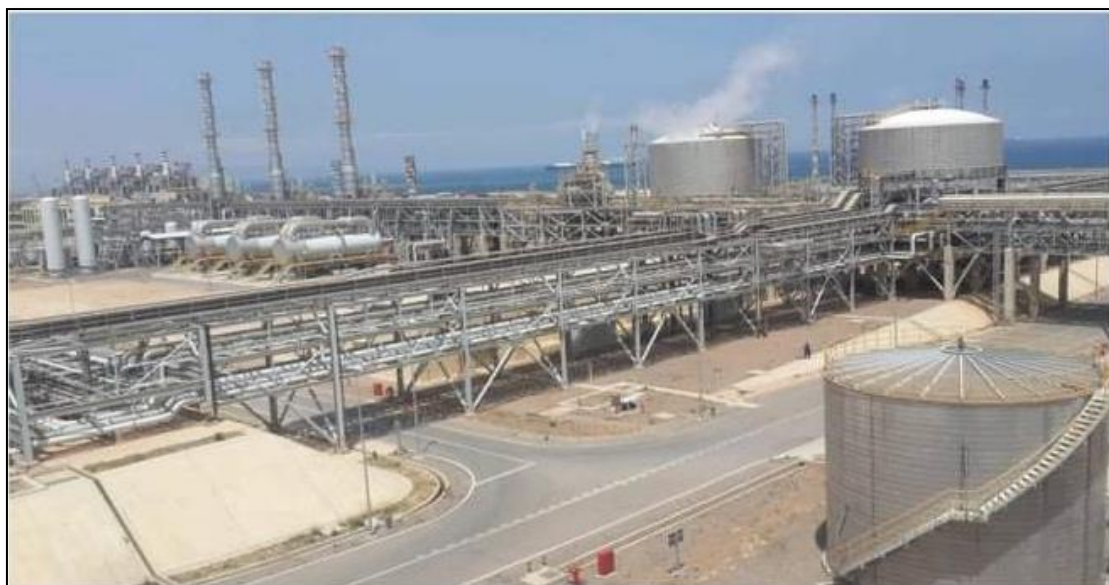
Fig.1.2 - Bacs de stockage de l'ammoniac liquide
