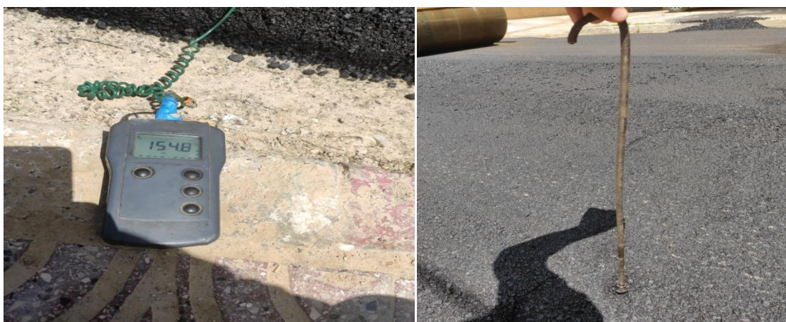
Figure III.10 : Contrôler la température.
