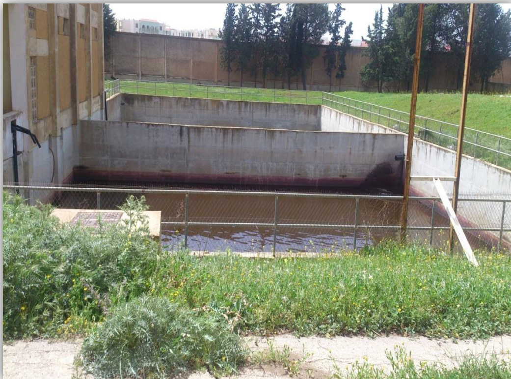
Figure N°25 : Les deux réservoirs de neutralisation [92]
