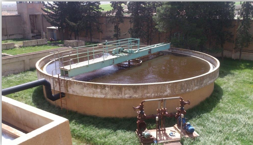
Figure N°29 : décanteur secondaire (clarificateur)
