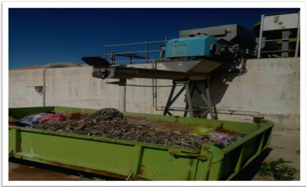
Figure 05 : Bassin de récupération
