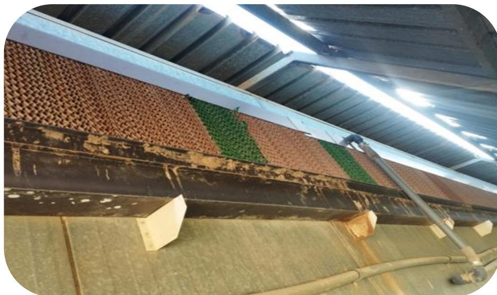
Figure 15: Système de refroidissement par évaporation (pad cooling) – vue extérieure
