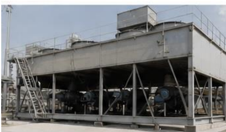
Figure II.4 : Aéroréfrigérants à tirage forcé
